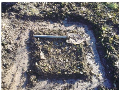
Accumulation des sédiments dans le bassin de rétention
